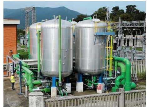
L'impianto di abbattimento del cromo già in funzione a Brescia
