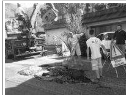
Gli operai del Comune di Lumezzane sistemano una delle voragini
