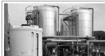
Un impianto per la depurazione dell'acqua che neutralizza il pericoloso cromo esavalente
