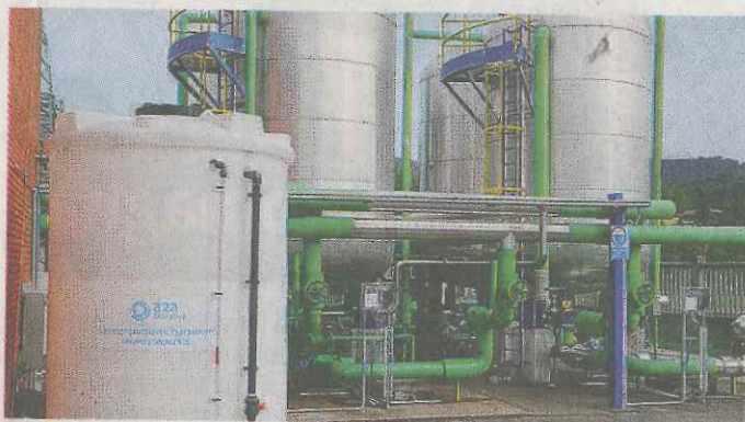
In città. Un impianto di abbattimento del cromo a Brescia
