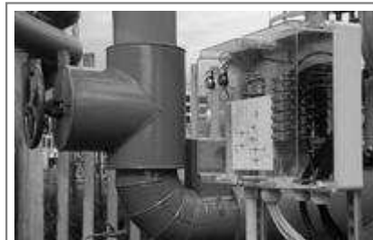
L'impianto per l'abbattimento del cromo esavalente di Brescia
