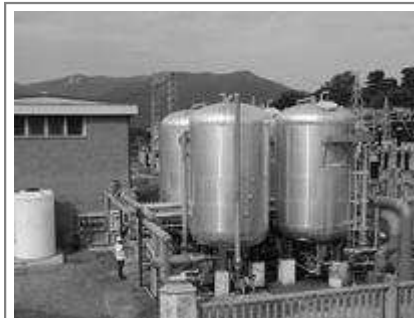
L'impianto realizzato da A2A in città e che presto sarà attivo anche nella vicina Concesio
