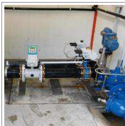
Nuovi impianti al servizio della qualità dell'acqua di Gardone
