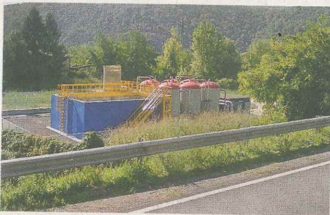
L'impianto. La struttura si trova in via Mazzini a San Vigilio
