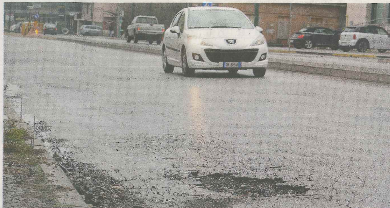
Tra le buche. Un tratto della strada Triumplina, con una delle buche che si sono aperte nei giorni scorsi a causa della neve, del sale e della pioggia.
